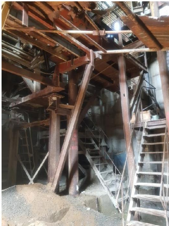
Фото № 2 металлоконструкции, трапы, лестницы
