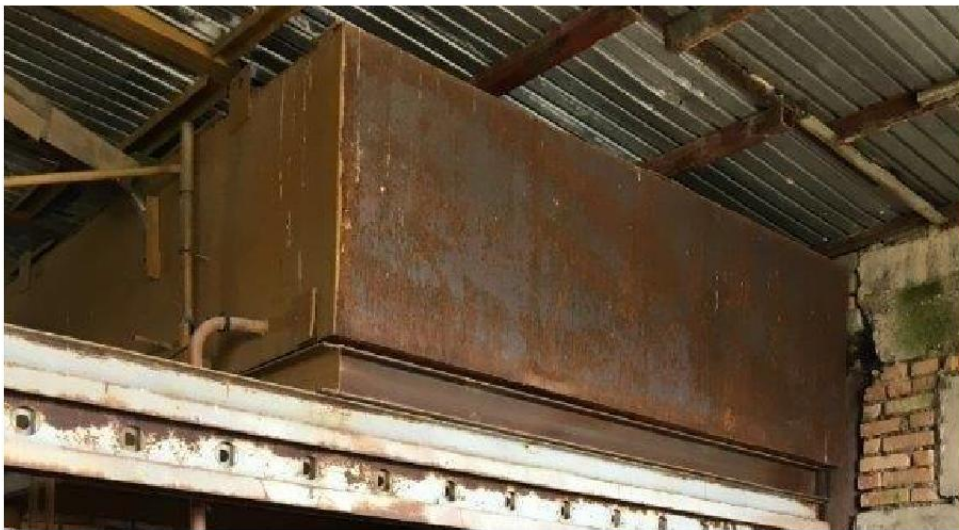
Фото № 4, 5 Бак водяной
